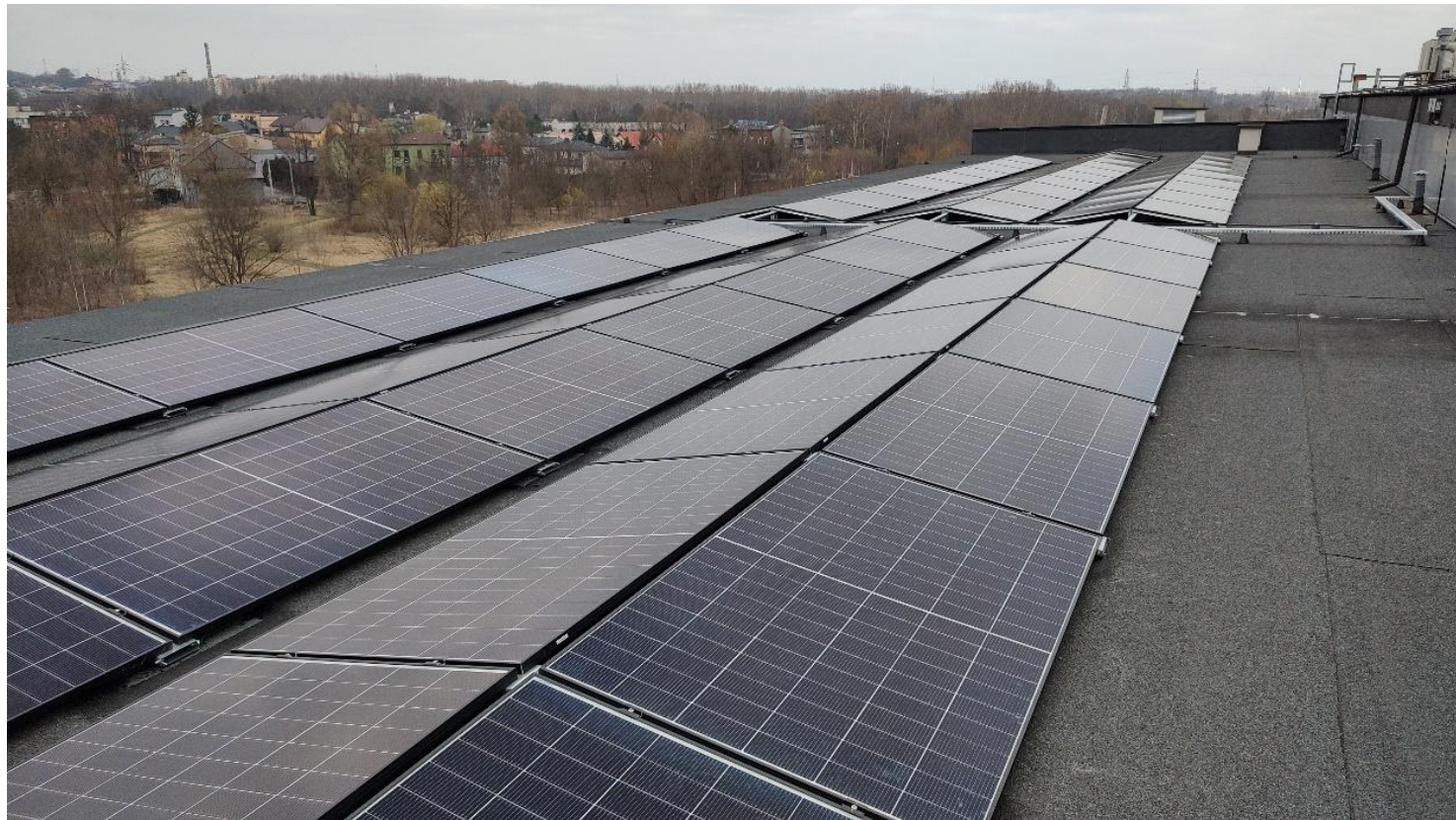
Instalacja fotowoltaiczna na budynku SPNT przy ul. Wojska Polskiego 8
