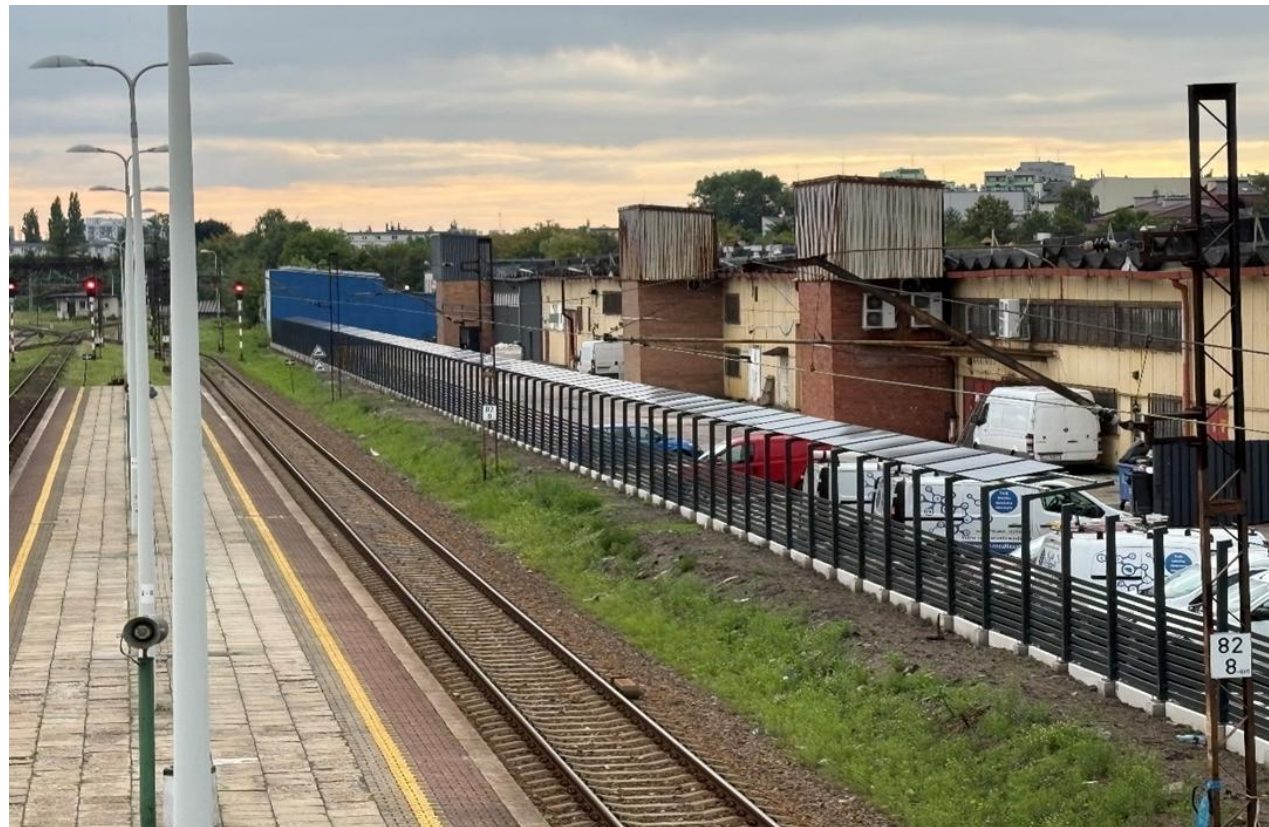
Instalacja fotowoltaiczna przy budynkach ARL S.A. na ul. Teatralnej 9 i 11
