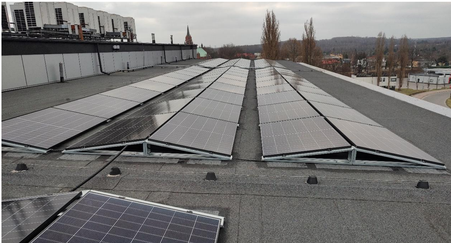
Instalacja fotowoltaiczna na budynku SPNT przy ul. Wojska Polskiego 8
