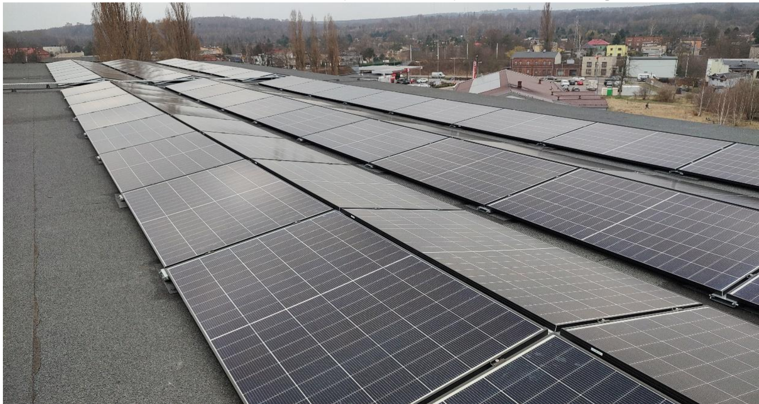
Instalacja fotowoltaiczna na budynku SPNT przy ul. Wojska Polskiego 8
